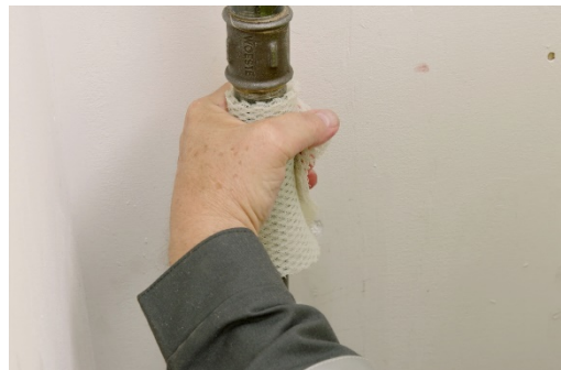
Foto 5 - Opruwen van een leiding
