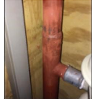
Foto 1 - Leiding met lekkende koppeling
